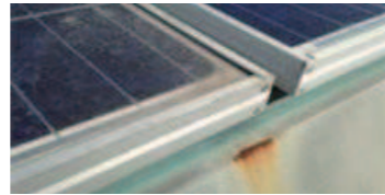
長期間使用時の折板屋根部のサビ被害写真
